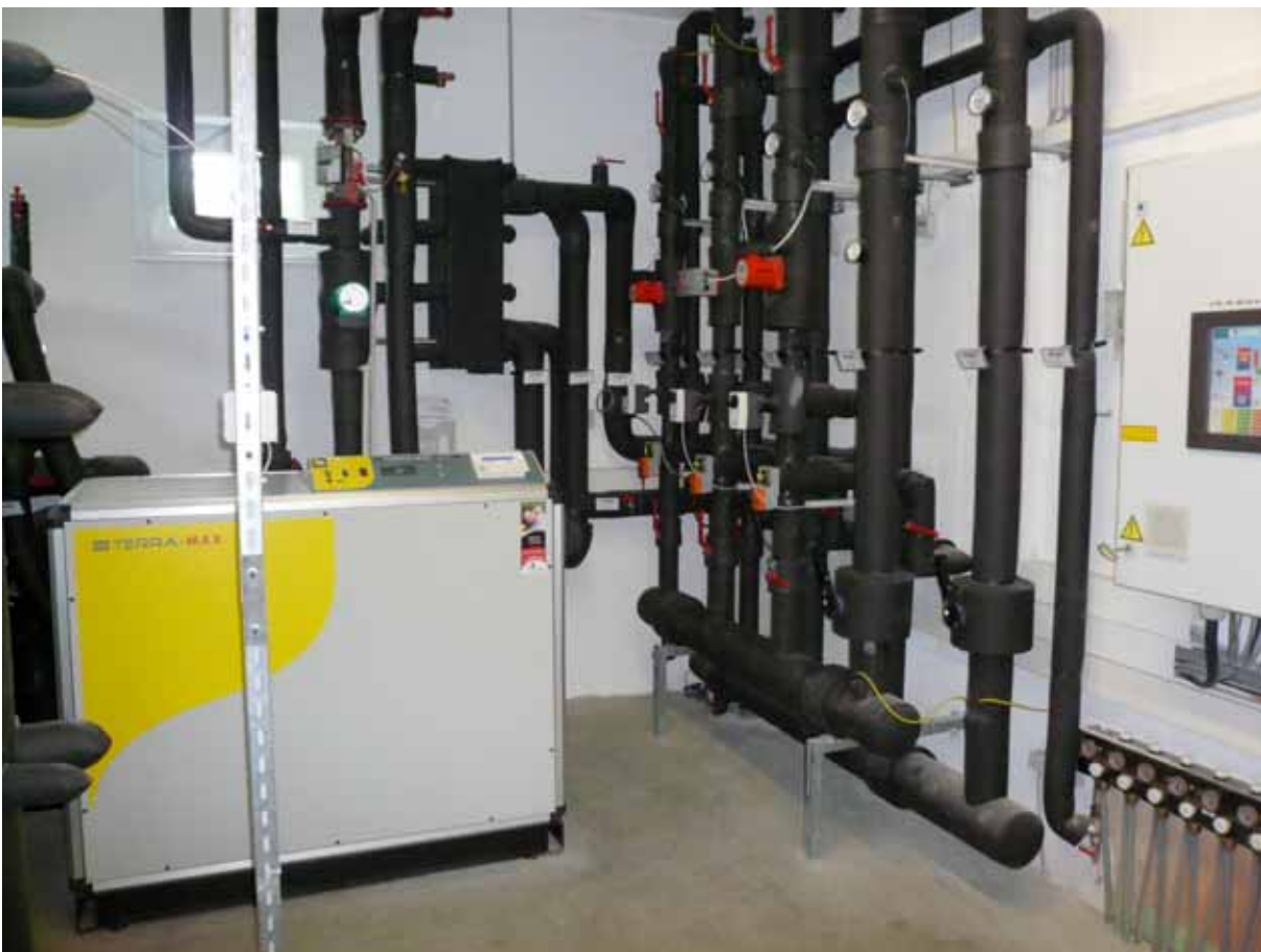
Heizung/Kühlungszentrale dampfdiffusionsdicht ausgeführt
